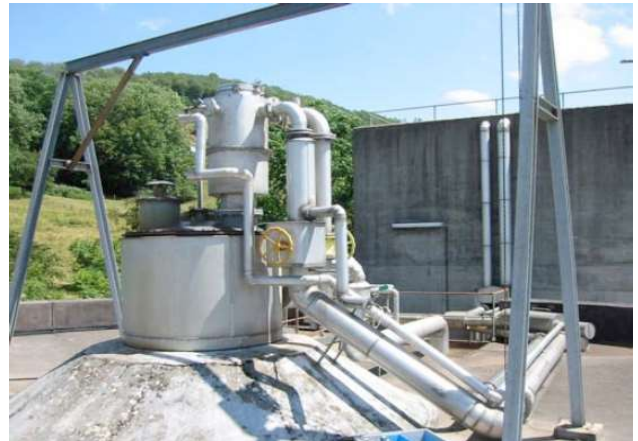
Abb. 1 – Probenahme Klärgas auf einer Kläranlage
