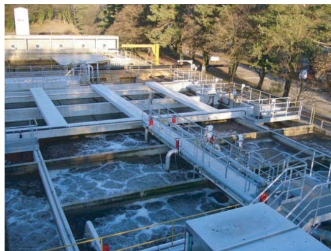
Abb. 3: Großtechnische Versuchsanlage für die Elimination von Mikroverunreinigungen in der Kläranlage STEP de Vidy in Lausanne (Kanton Waadt, Schweiz)
